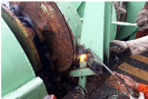
Gambar 2: Korosi pada Mata Rantai.
